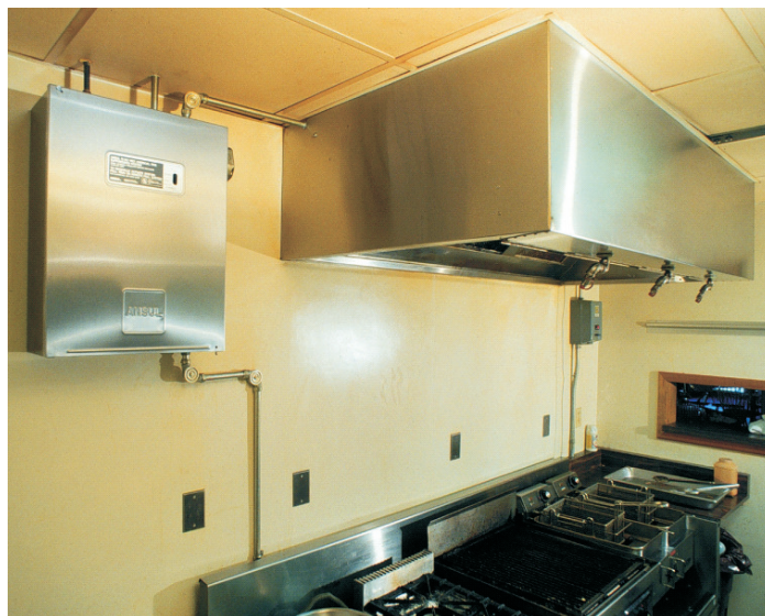
ANSUL R-102 sustavi estetski se uklapaju u interijer kuhinje budući da je sva važna oprema izrađena od inox-a (uključujući cjevovode, fittinge, mlaznice i ovjese)
